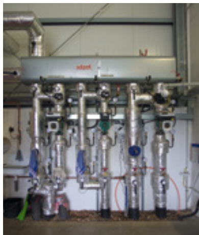
Verteilerstation für Nahwärmeversorgung
