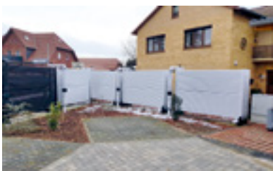
Eisspeicher in Wahrenholz
